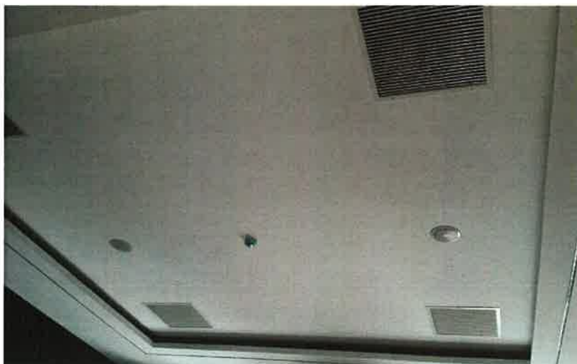
Foto: Cabluri iluminat lipsa, aripa dreapta
