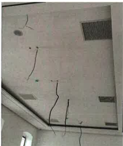
Foto: Cabluri iluminat, aripa stanga
